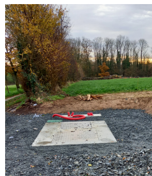
Pompe de relevage à Vayande
